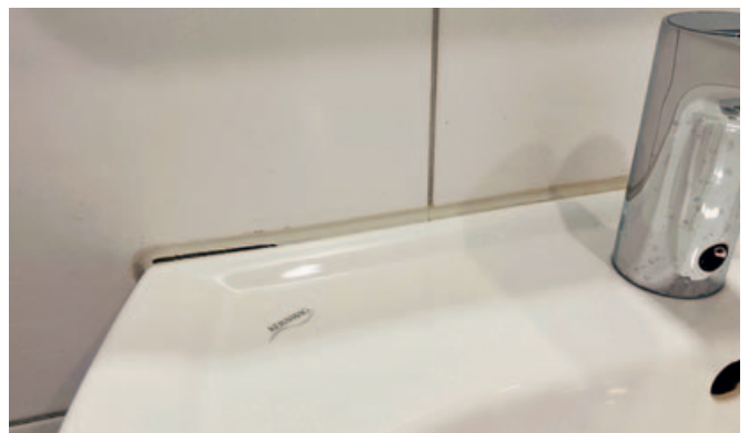
Ein klassischer Fall für eine Schadensmeldung: Eine gerissene Silikonfuge im Badezimmer. Dringt Wasser ein, können auf Dauer größere Schäden entstehen. Foto: Philip Hauck
